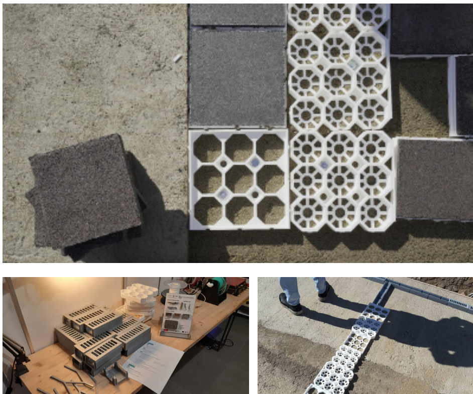
Fig. 31. Posa in opera del Green Parking per gli scenari PVC UpCycling. (fonte: elaborazione PMopenlab, 2019)
