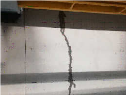
Fig. 33 - Infiltrazioni di acqua durante la simulazione del test in assenza di vento / Water infiltration during the test simulation in absence of wind (Source: Authors' elaboration).
