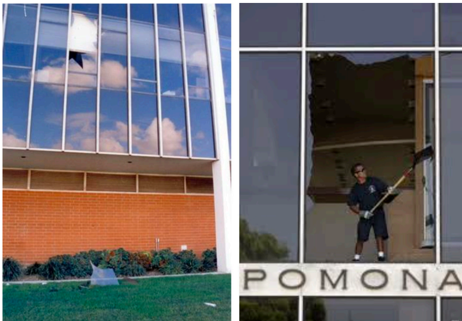
Fig. 4 Fallimento degli elementi vetrati (Terremoto Northridge 1994)
