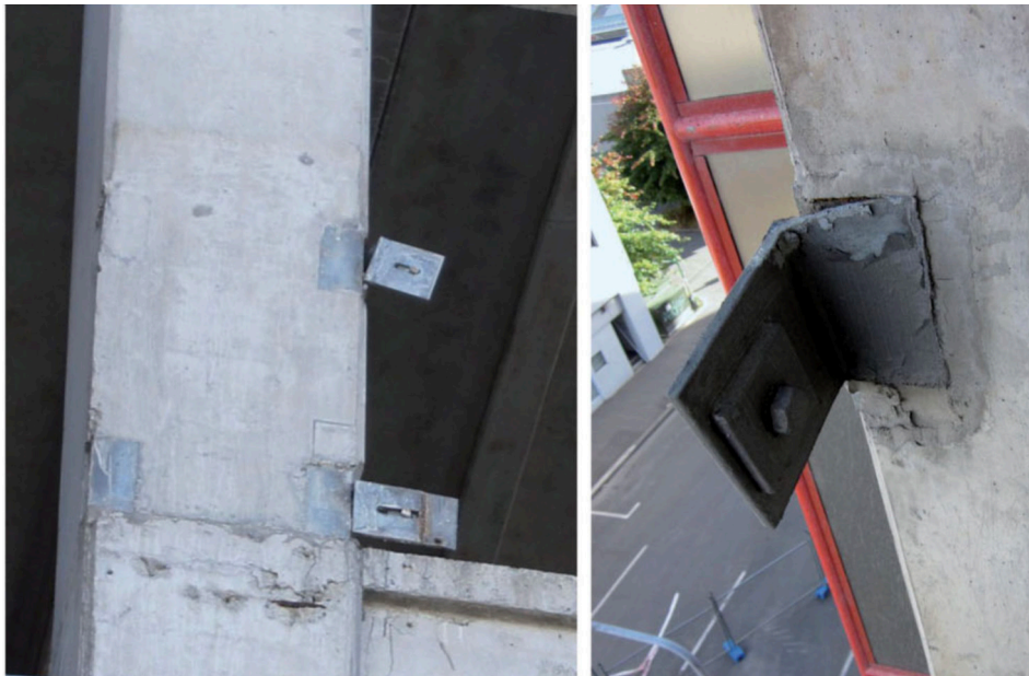
Fig. 6. Fallimento degli elementi di connessione (Terremoto Christchurch 2011)
