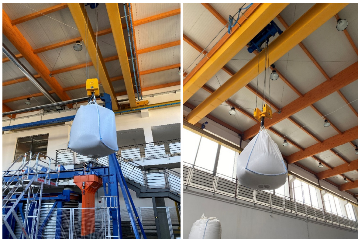
Figura 5.31 Fase di movimentazione di una big-bag mediante uso del carro ponte
