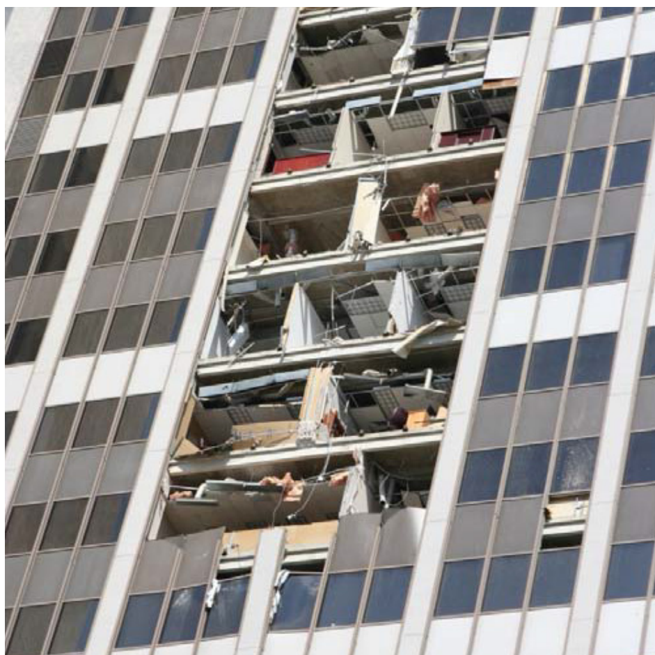
Fig. 3.22 Fotografia del crollo di una facciata continua. Fonte: Bui, N., Merschbrock, C., Munkvold, B. E., 2016.
