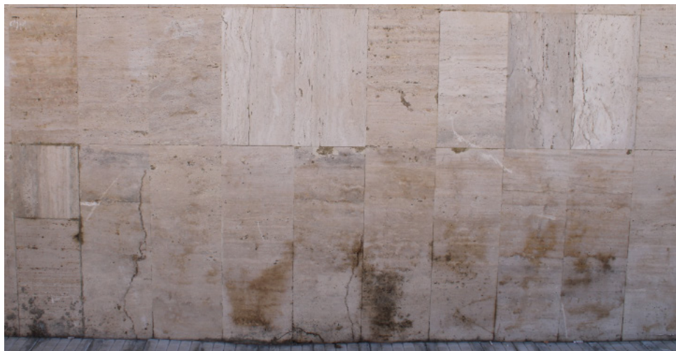
Fig. 2.14 Stazione Centrale e Marittima: lesioni nelle lastre dei filari inferiori.
