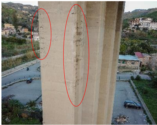
Figura 5.15 – ammaloramenti sulle pile
