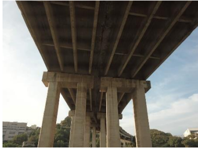
Figura 5.6 - Centralina di Controllo- struttura viadotto
