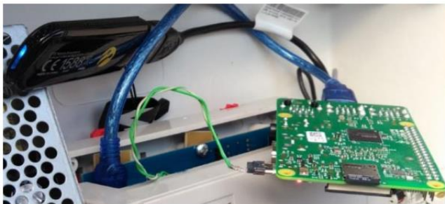
Figura 5.3 - Centralina di Controllo
