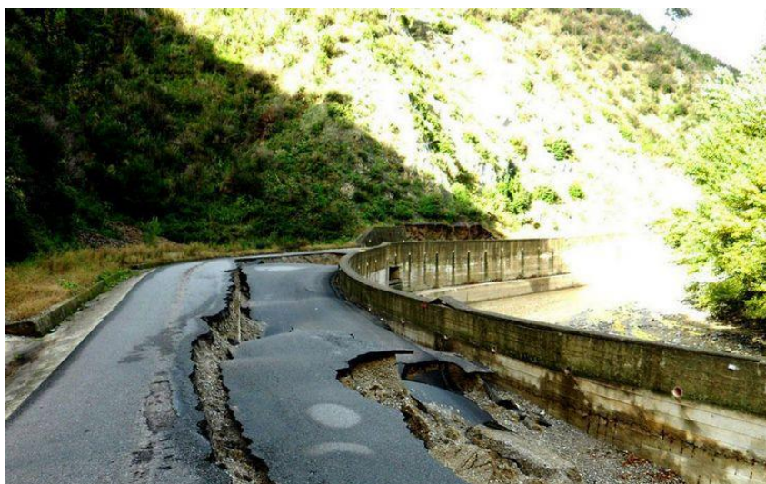
Fig. 2.5 Allagamenti e danni alle infrastrutture per l'esonazione delle fiumare nel Novembre 2013.
