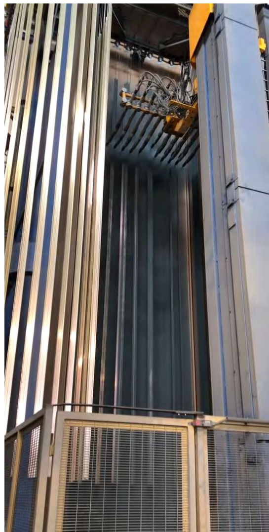
A lato: Impianto automatico verticale di verniciatura in polvere dei profili di sponibile presso l'impianto Anodall di Trevenzuolo (VR)
