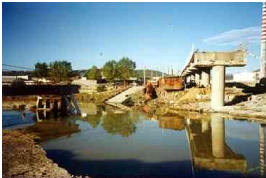
Fig. 2.2 Crollo del cavalcavia all'ingresso della città.
